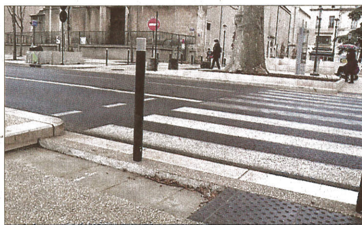
■ Même pour les valides, c'est le genre de piège qui peut faire mal... Il reste de nombreux trous, notamment sur le boulevard Gambetta.
